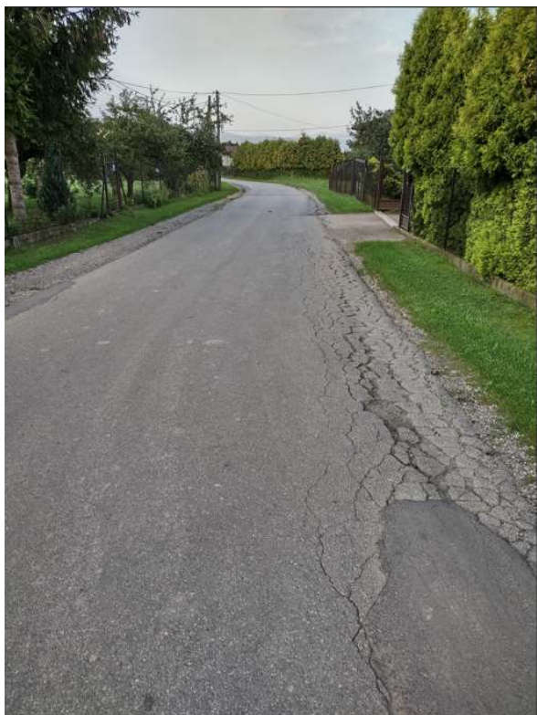
Fot 9a ul. Podlas
